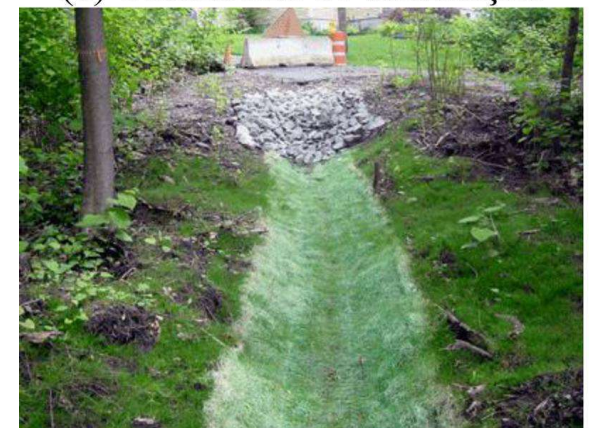
(d) Vala de infiltração
