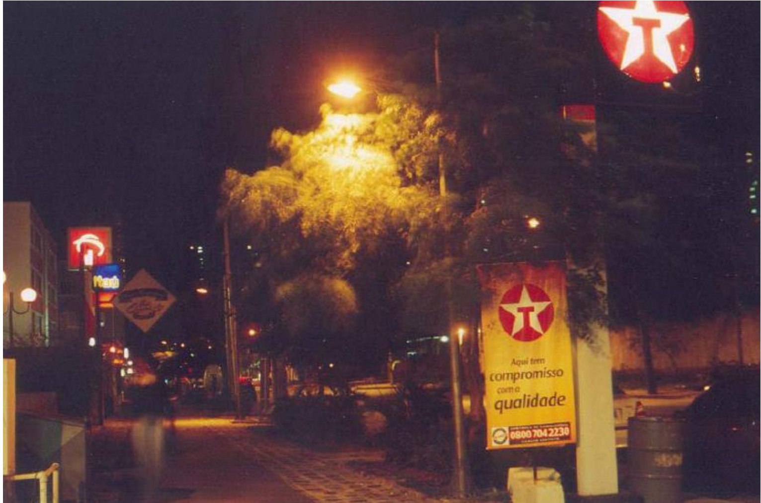
Interferência da arborização na iluminação pública
